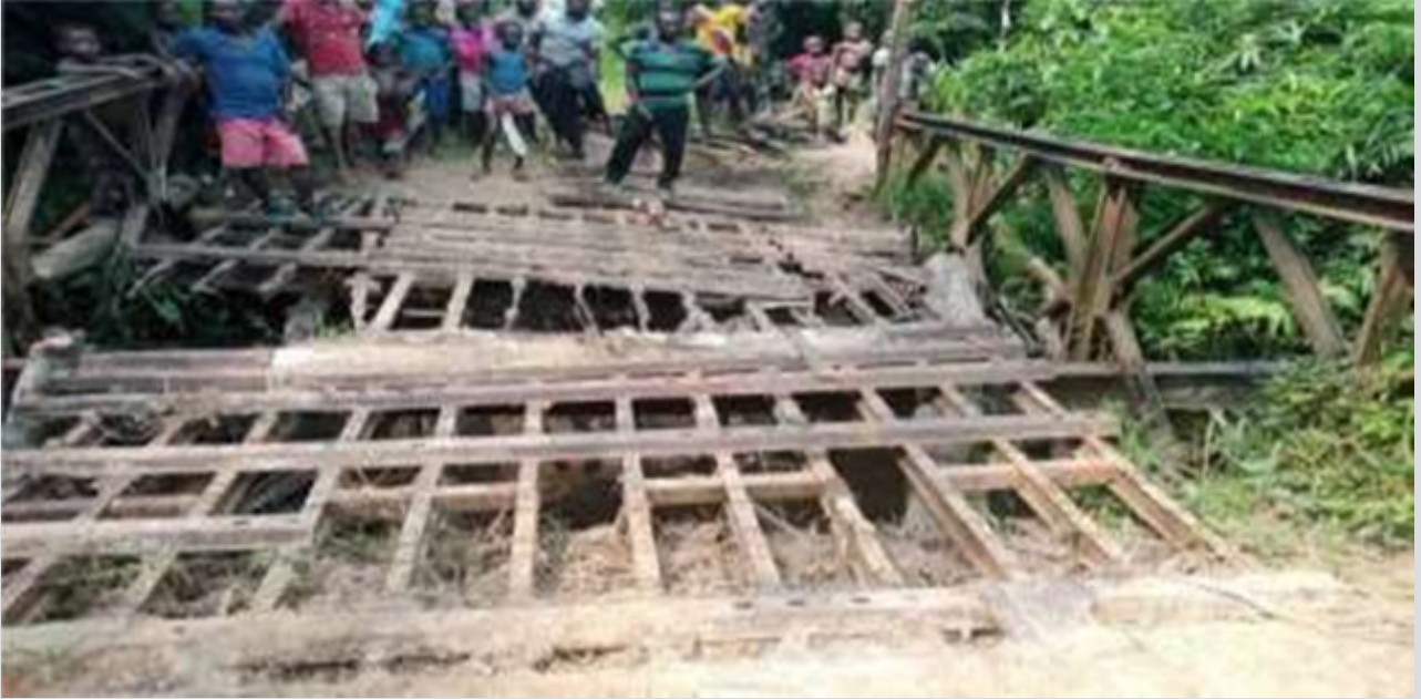
1.3.3. état du pont ya lisubu pendant la période de FERONIA
